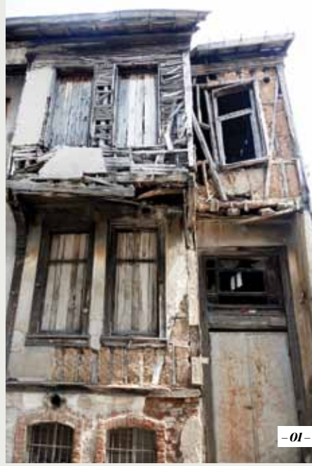
-01- Bursa Tophane Semti'ndeki 6. Kavaklı Sokak'ta bulunan göçük riski olan bina yıktırıldı.
